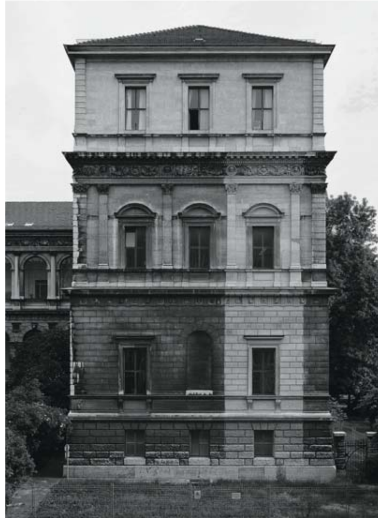
„Vorsicht! Herunterfallende Fassadenteile“, Ostflügel 1998
